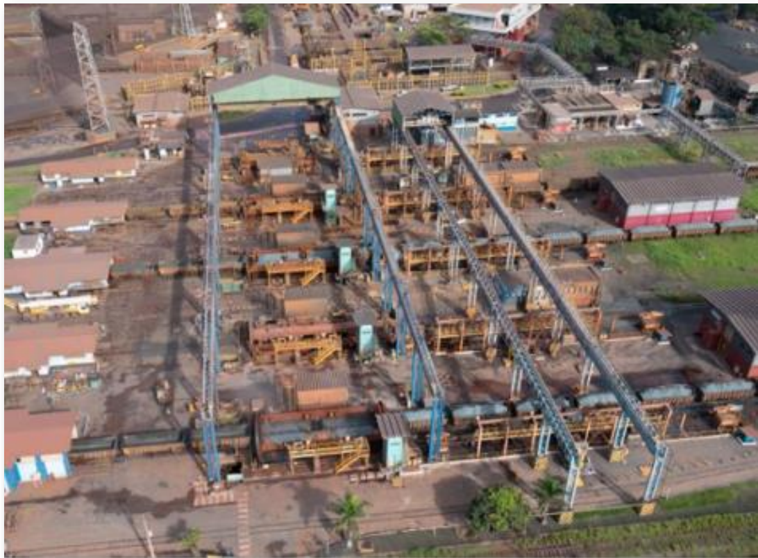
situação atual: controle das emissões feito através de sistema de dupla aspersion de água durante o descarregamento.
