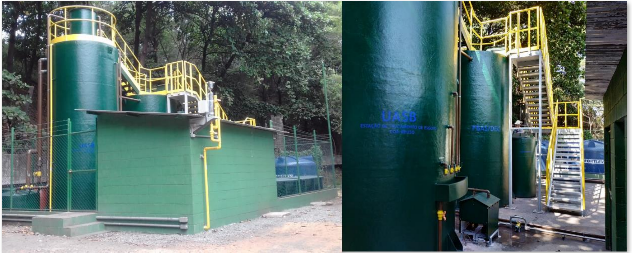
ETE em operação nas usinas de pelotização I a IV.
