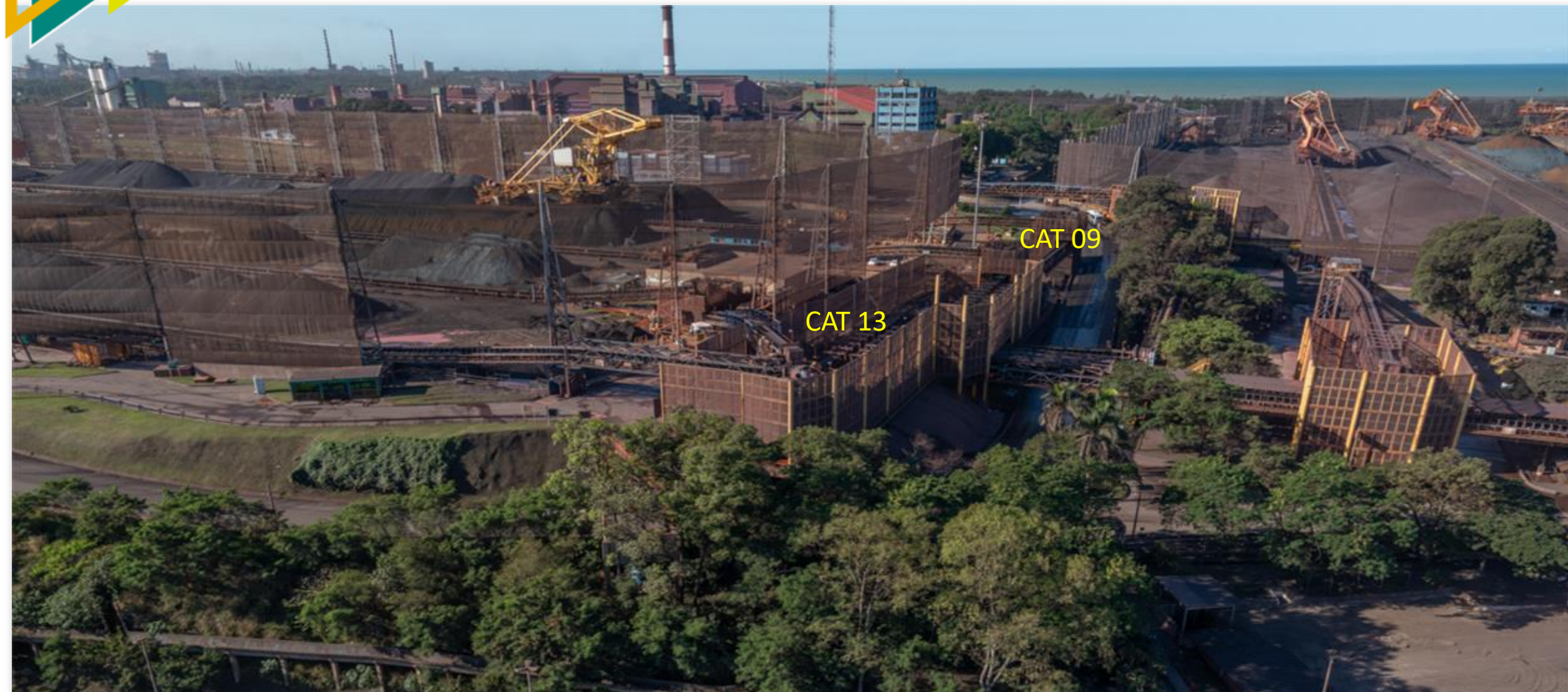
obras de fechamento das casas de transferência da rota de embarque dos píeres 1 e 2.
