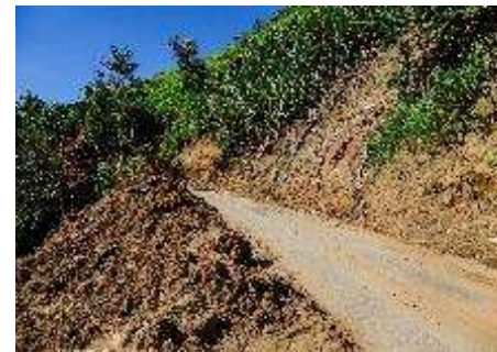
Local com material aplicado atingido pelas fortes chuvas em fevereiro de 2020
